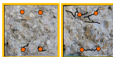
図5 内部ひび割れ性状
