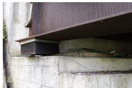
写真-4 2016 熊本地震によるゴム支承の被災
