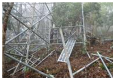
図 2 台風 24 号により損害
