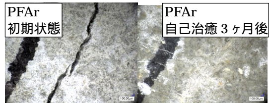
図4 ひび割れを導入した補修材の自己治癒状況
