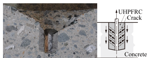
図-5 切断した試験体のひび割れ図
