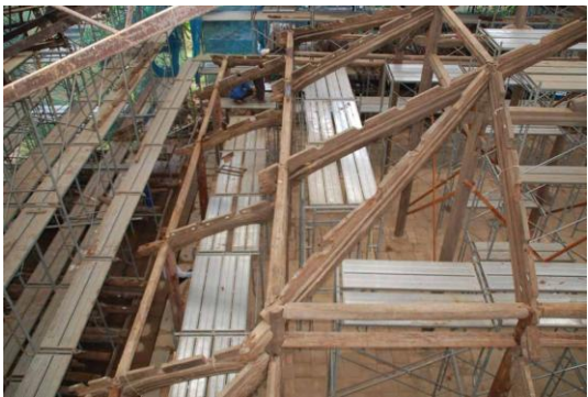
写真8 柱の伸び・内転び
