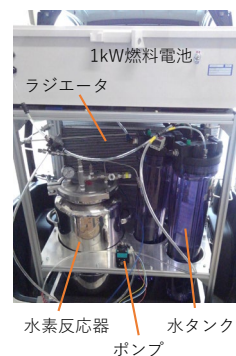
図 3 1kW 燃料電池用水素発生システム
