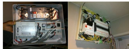
図1 計測対象及びエネルギーモニター設置状況
