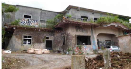
図 3 D19 腐食鉄筋を採取した建物
