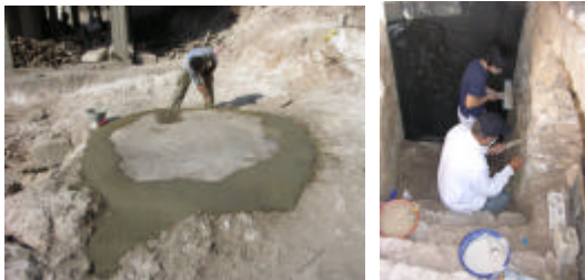
モルタルによる天井コンクリート蓋縁の雨水流入防止作業(左) モルタルによる壁面剥離防止作業(下 階段東壁)
