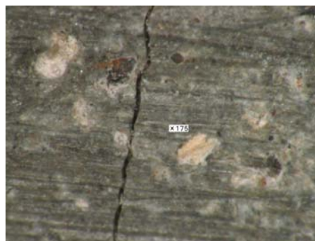
図 2 ひび割れ拡大写真
