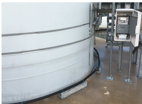
図1 タワー根本に設置されている落雷検出装置
