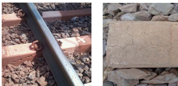
図 3 インド鉄道の損傷 PC マクラガ
