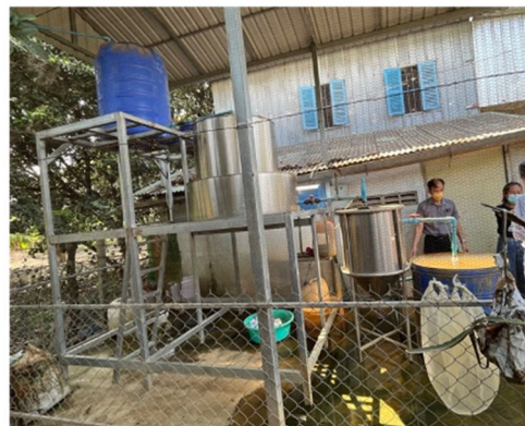
図6. 現地に建設した浄化装置
