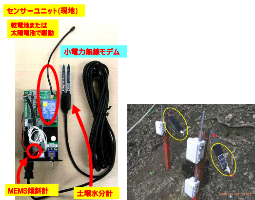
図4 センサーユニット(左)と太陽電池による電源供給(右)
