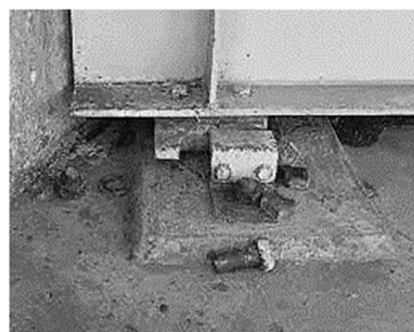
図1 支承の破損事例11
