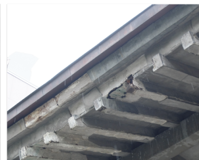
写真5) 長源寺本堂軒裏 / 山形県山形市 モルタルの垂木
