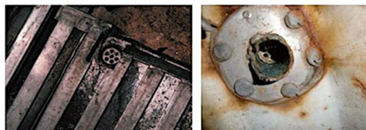
図4 ドレン排水口(左) ドレン排水口ラバーの欠損(右)
