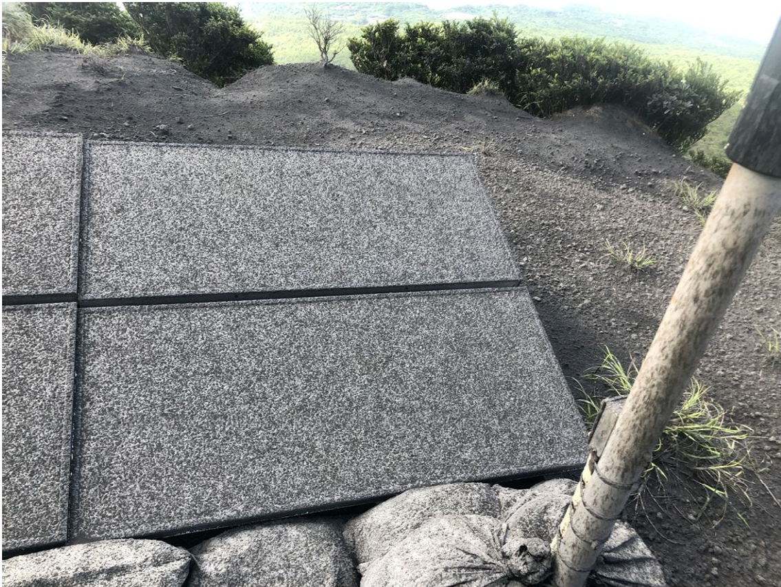
写真 1 . 2020 年 8 月 9 日 ( 5 : 38 ) の噴火の噴出物に覆われた火山観測設備
