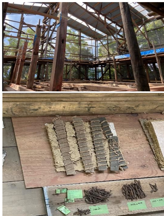
図6 文化財建築物の解体修理現場(上)で得られる生物試料(下):石清水八幡宮撰社狩尾社本殿
