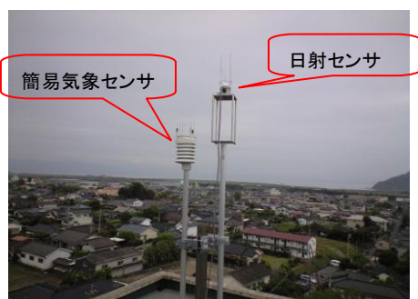
図5 鹿児島高専屋上のセンサ設置状況
