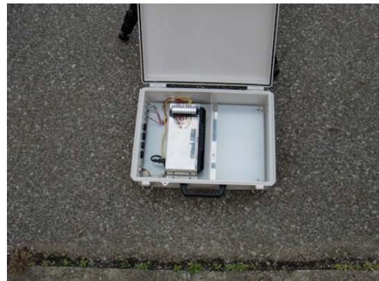
図-11 電源・通信ボックス
