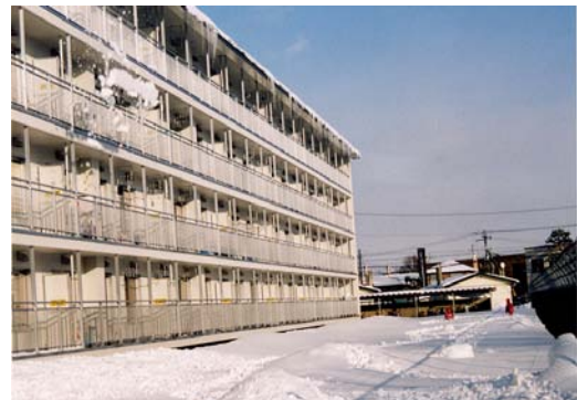
写真 3-7 屋根からの落氷雪
