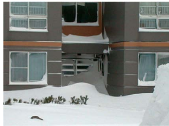
写真 3-4 開口部前の吹きだまり
