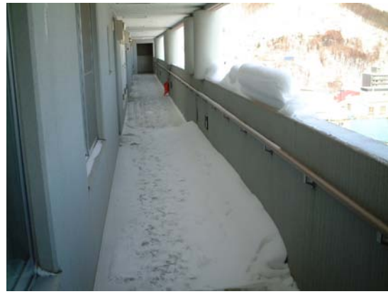
写真 3-3 開放型廊下における雪の吹き込み
