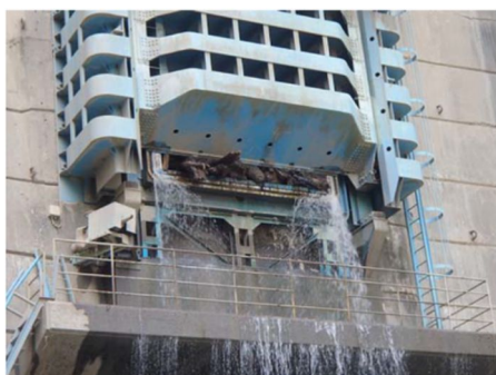
図-1 土砂および沈木による ゲート操作不能状況
