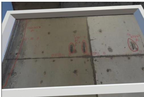
図-8 損傷図を表示した 3D モデル
