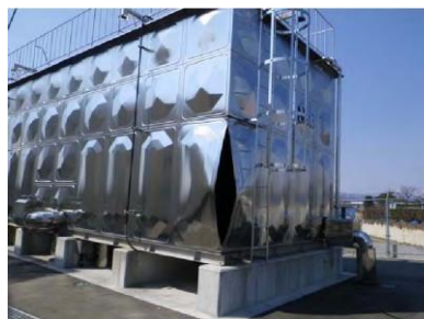
写真2 下部隅角部付近の破損事例(バルジング)
