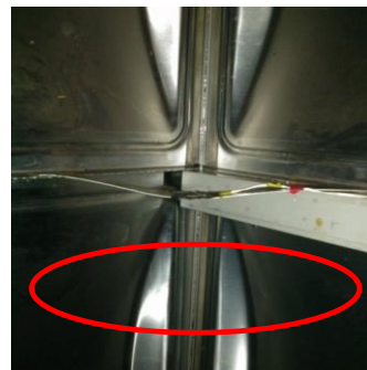
写真4 貯水槽内部補強材座屈
