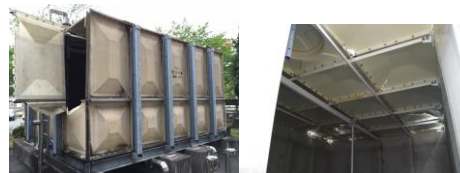
写真1 天井や側板の破損事例(スロッシング)
