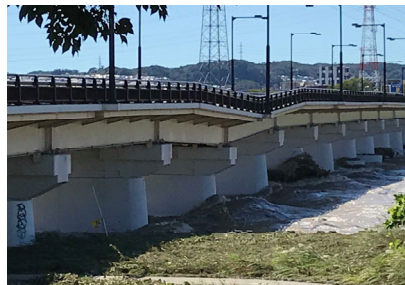
図1 甲州街道日野橋の被災状況 (2019年10月13日研究代表者撮影)
