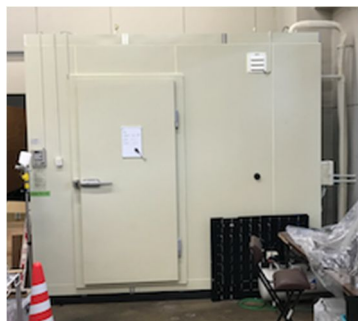
図1 製氷用冷凍庫
