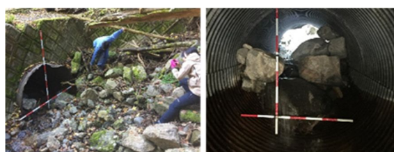
写真-2 林道の暗渠の閉塞事例
