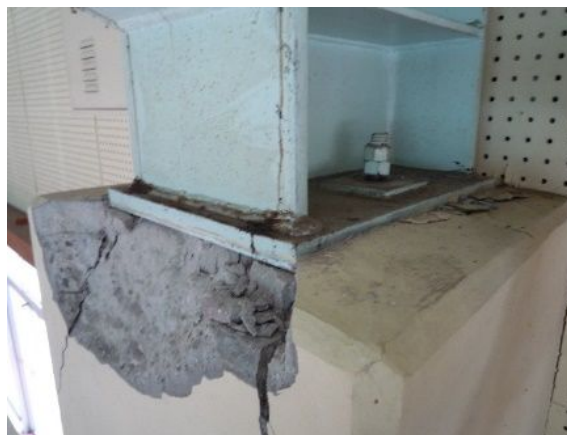
図1 屋根取り付け部の損傷
