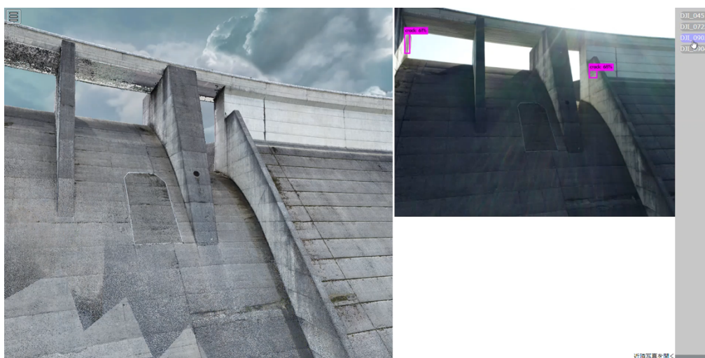
図 3 3 次元モデル (左) とひび割れ検知した画像 (右) を並べて表示した画面
