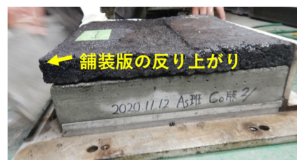
図-2 舗装版の反り上がり
