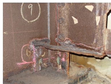
図-1 橋桁端部の腐食状況
