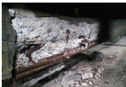
図2 継手部の破壊
