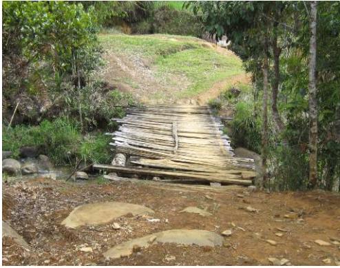
図 4 不安定で車両が通行できない橋
