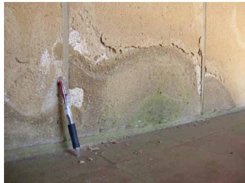
図2 近代建造物の壁面における塩類風化
