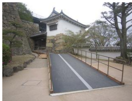
写真4 姫路城における「平成の大修理」に伴うバリアフリーの事例(仮設のスロープ設置による段差解消・傾斜路の勾配緩和)
