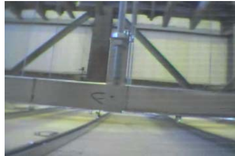
Figure 11 検査ロボットから損傷箇所の映像
