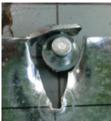
A: 端抜け後せん断破壊
