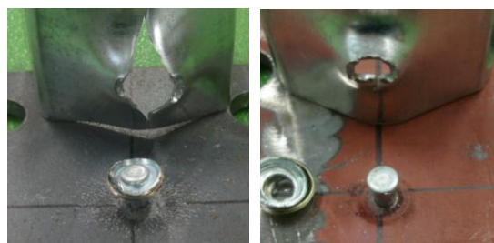
A: デッキ破壊 B: 撃込み鉄の座金抜け
