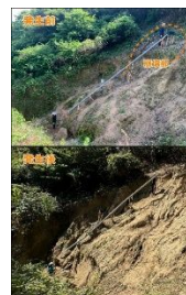
図-4 2022年に設置した伸縮計の設置状況と崩壊発生後の状況(斜面上部の伸縮計設置位置で崩壊)。
