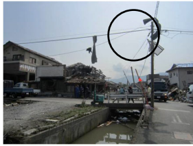
写真1 電線と電柱への飛来物の付着
