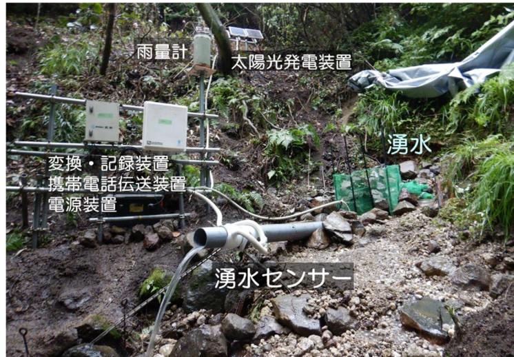
図8 始良カルデラ壁に設置した湧水センサー
