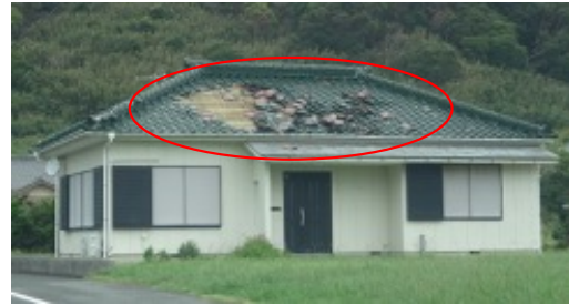
図2 低層建築物の強風被害の例
