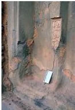
写真1 偽扉下部の風化凹み
