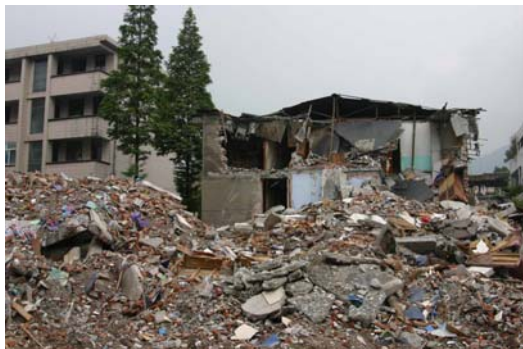
写真 5 水電 10 局団地の被害
