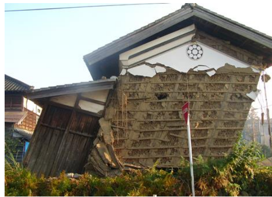
写真1 地震後傾いたまま立っている土蔵
