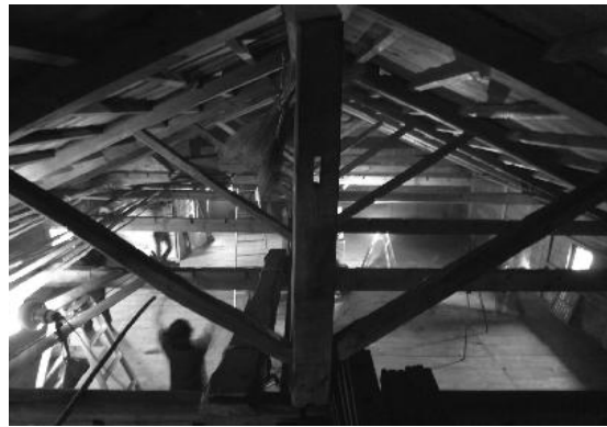
写真1. no. 1 の小屋組にみられる部材転用の痕跡
