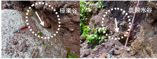
図4 湧水発生状況
