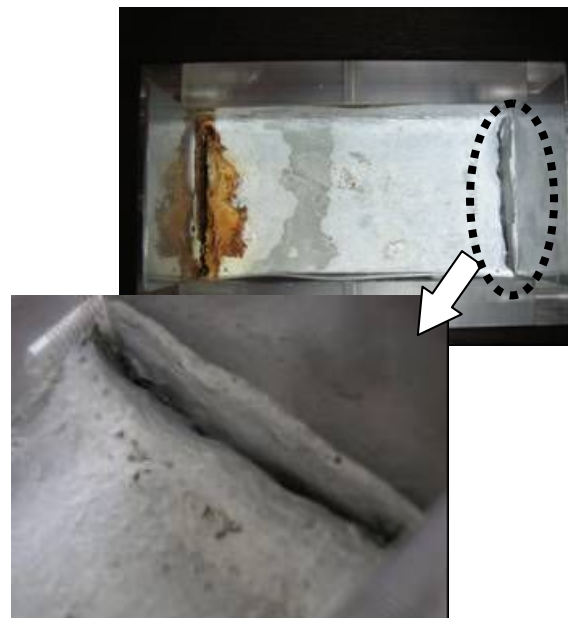
図 4 セメントモルタルの陰極側剥離部
