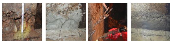
(a) 12L/分の漏水場所 (b) 注入プラグ取り付け (c) 無機系止水材注入 (d) 自己治癒材料塗布
