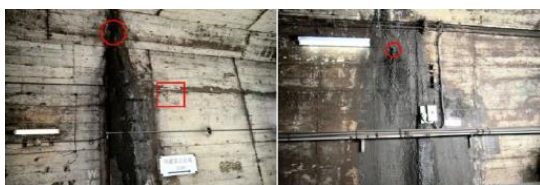
(a) 新規漏水箇所 (b) 再漏水箇所 図-4 漏水状況
